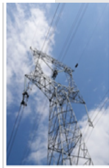
Línea en 500 kV Carrasco – Santivañez
